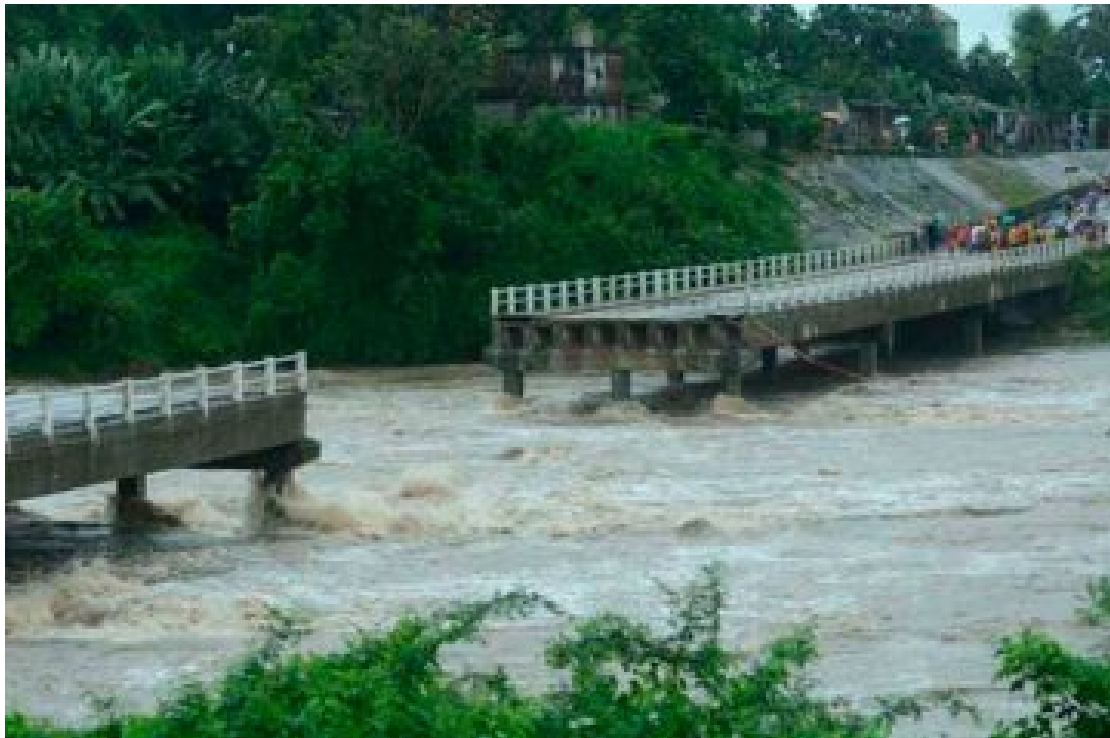
La tormenta subtropical Alberto provocó daños severos en varias provincias, las fuertes lluvias hicieron colapsar el puente del río Zaza en la central Sancti Spíritus.
